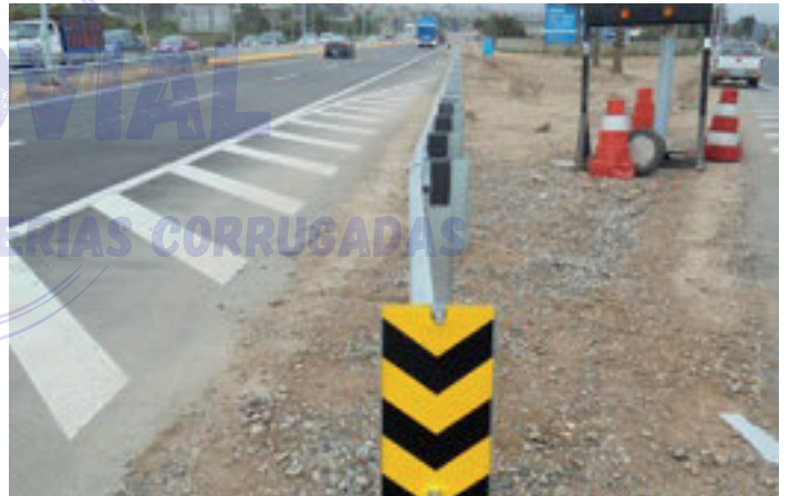
Ruta 5 Norte, Paso Inferior Cuatro Esquinas, La Serena. Terminal Atenuador del Tipo Extrusor con Nivel de contención TL3
